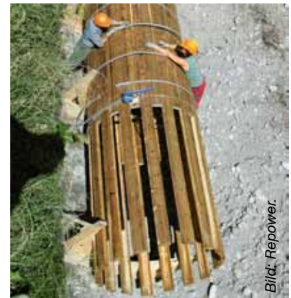
Die Verantwortlichen bei Repower hoffen, dass durch den Einsatz von Holz im Leitungsbau andere Werkstoffe preisgünstiger werden.
