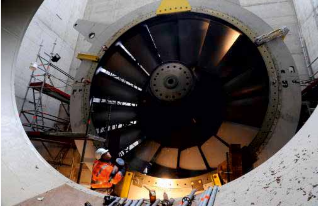
Der Leitapparat dient zur Wasserregulierung der Turbine.
